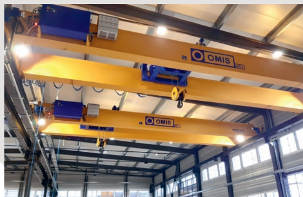
20.0 T Laufkräne in 2-Träger Bauweise. Spannweite 15 m
